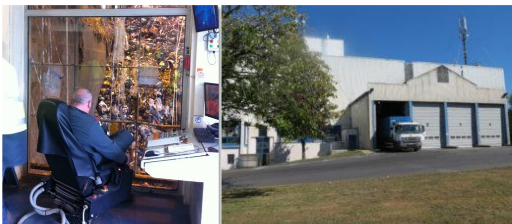
Poste de pilotage du chargement des fours à l'U.V.E de Concarneau et vue extérieure de l'U.V.E.
