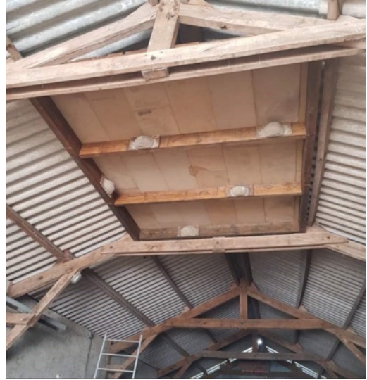
Figure 5 : Exemple de réalisation dans un hangar
