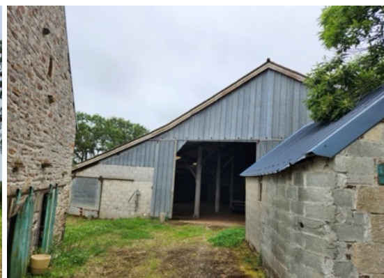
Ancien hangar agricole partiellement amianté
