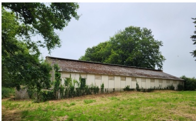
Ancienne porcherie amiantée
